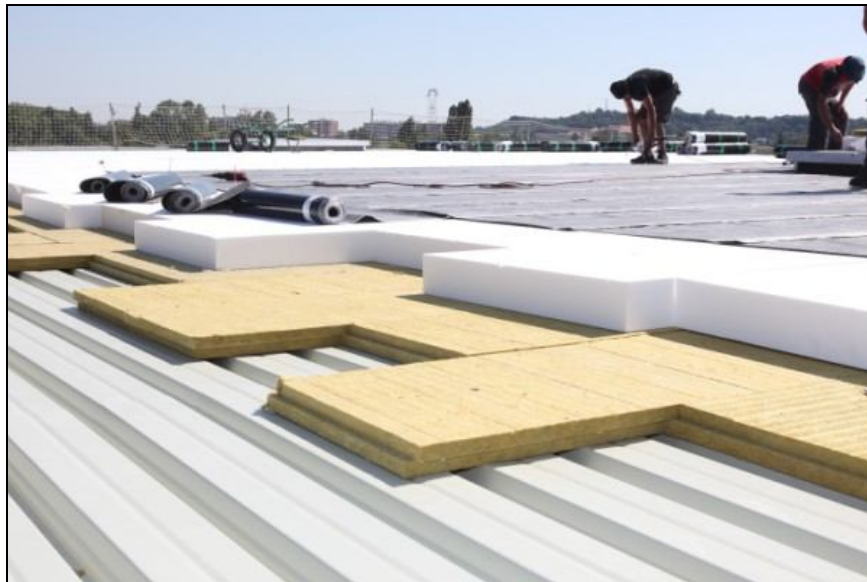
La toiture du nouveau Leroy Merlin de Valence associe légèreté et résistance à la compression
